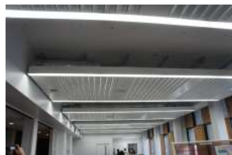
執務室天井の輻射空調システム (井水利用)
