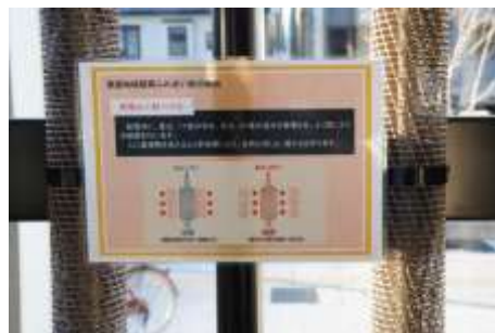
チューブ型放射用空調ラジエータ (井水利用)
