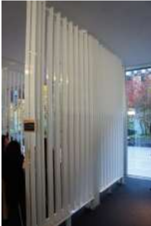
放射空調用ラジエータ (井水利用)
