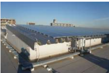
屋上に設置されたソーラーパネル
