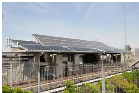
屋上階に設置された太陽光発電パネルと太陽熱パネル
