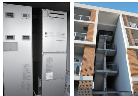
(左) 廊下側に設置された家庭用燃料電池エネファーム (戸建用を活用) (右) パッシブ設計 (通風と採光、断熱性等に配慮した住棟設計)
