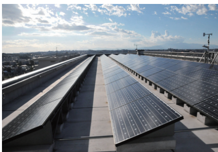
太陽光発電パネル (傾斜角 20 度)
