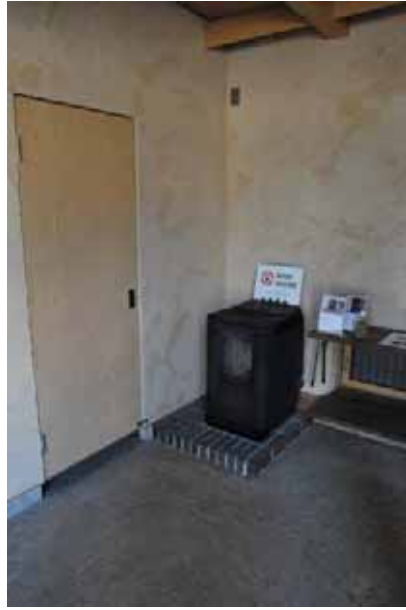
南棟に設置されたペレットストーブ
