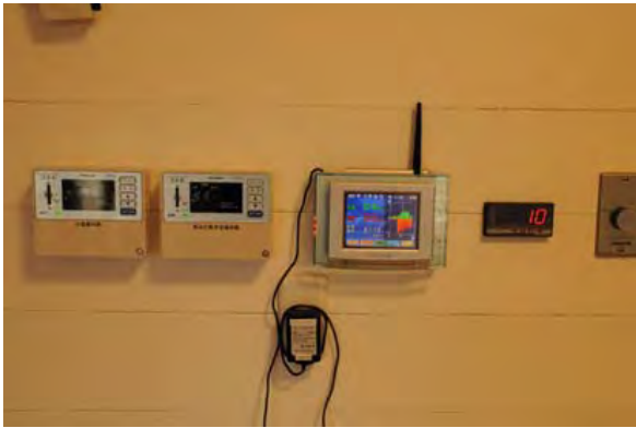
太陽光発電量など各種モニター装置
