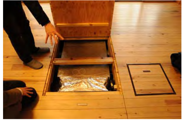
床下に設置された、地下水熱を利用した空調システムのファンコイルユニット
