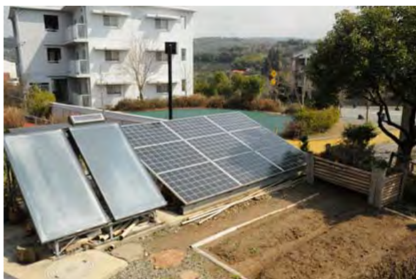
意図的に庭に設置された太陽光発電パネルと太陽熱給湯システム
