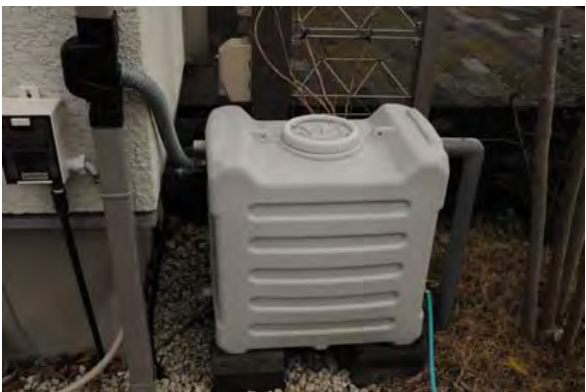
涼風ミストに使用する雨水タンク
