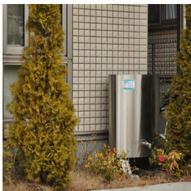
図 3-2-1-6 雨水貯留タンク
