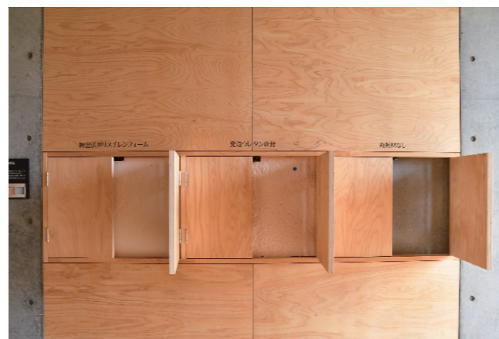
廊下に設置された断熱材観察窓
