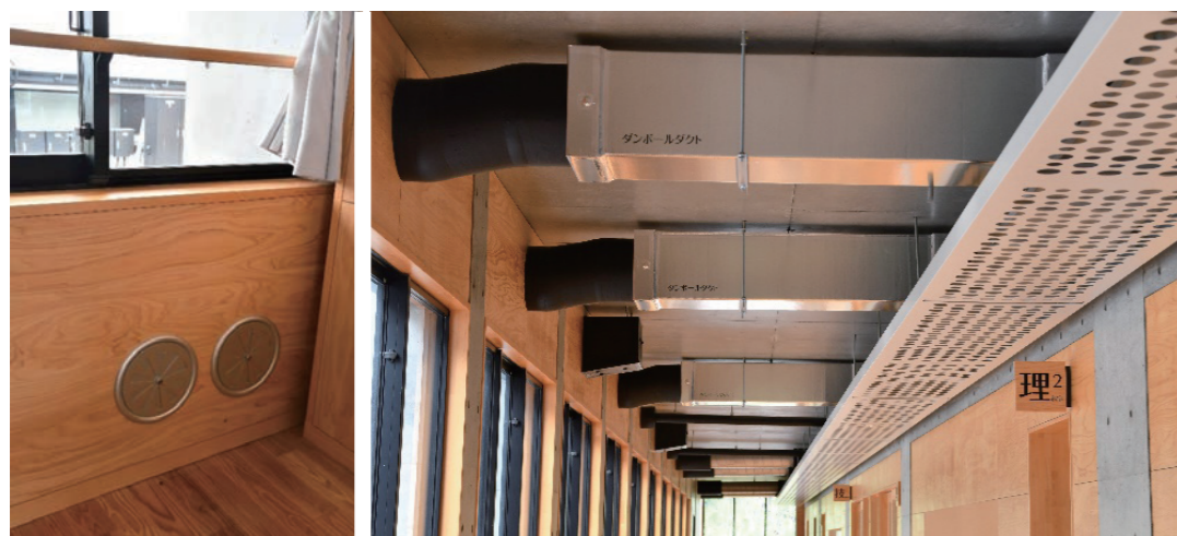
窓下の太陽熱集熱ウォールと 廊下に露出して設置された換気用ダクト 空気導入口（レジスター）
