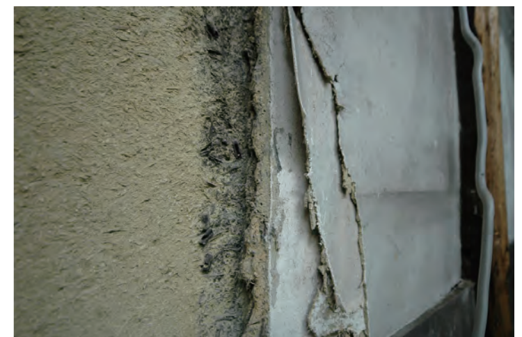
[06] 漆喰を塗り重ねた際の剥がれ。
